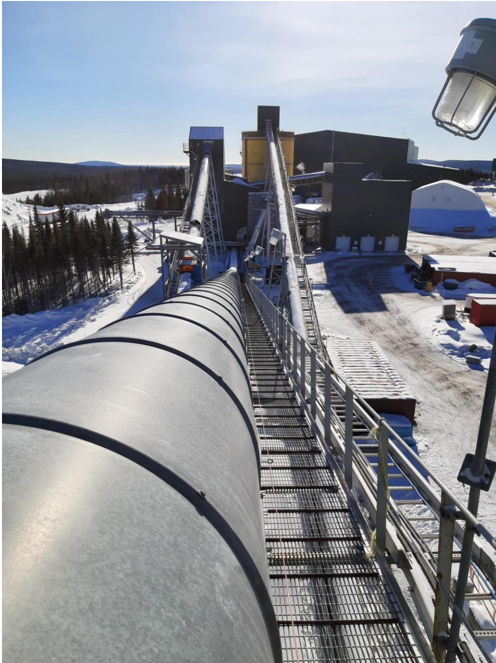
Les infrastructures de concassage et les principaux convoyeurs
