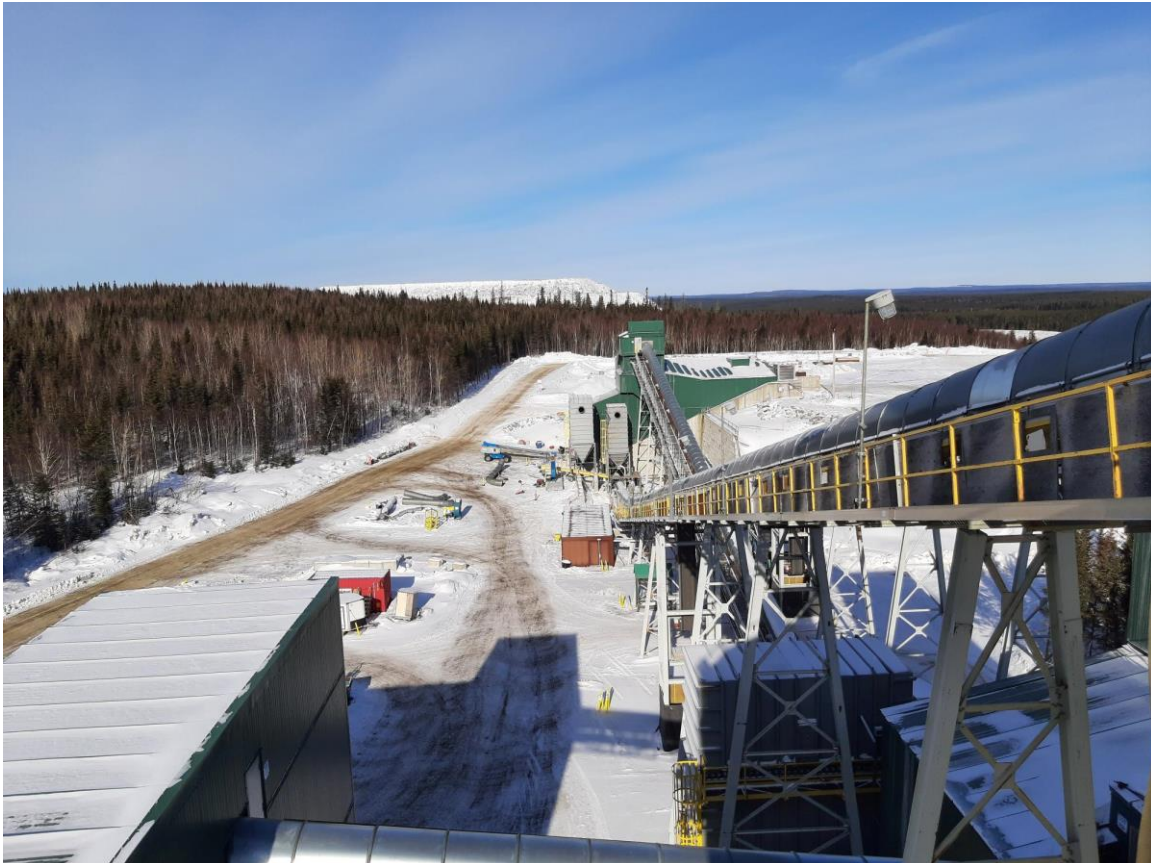
Les infrastructures de concassage et les principaux convoyeurs
